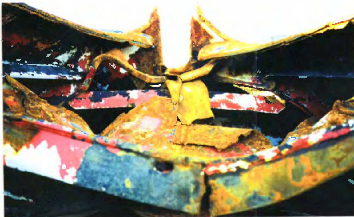
10.4 Visiiri põh- jastruktuuri kahjustused
